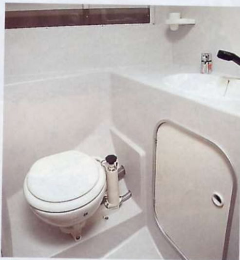
La toilette è un monoblocco di vetroresina che semplifica pulizia e manutenzione. La doccia è dotata di pompa di sentina e miscelatore.
