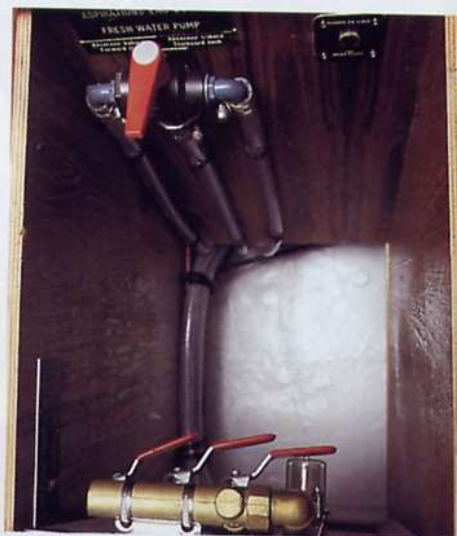
La parte terminale del tavolo nasconde un vano dove sono raggruppate le valvole del circuito idrico e funge anche da pattumiera.
